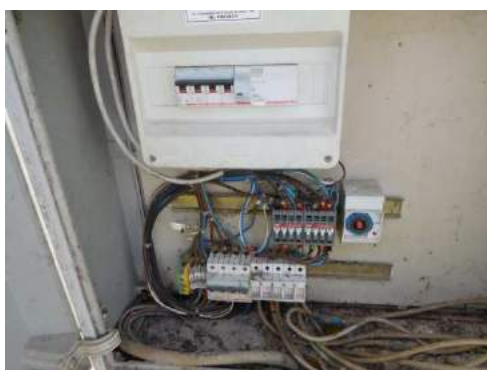
Q7 Quadro elettrico Via Platani
