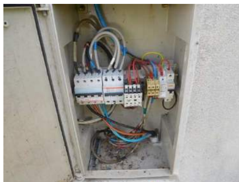
Q6 Quadro elettrico Via delle mimose
