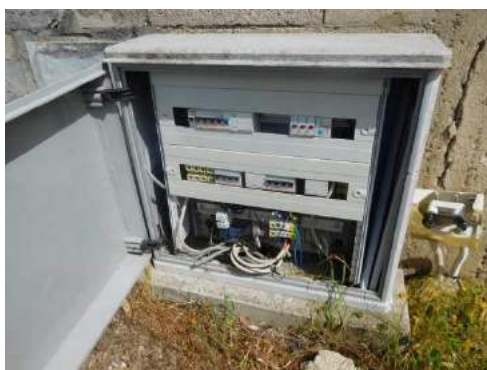
Q8 Quadro elettrico Campo Sportivo
