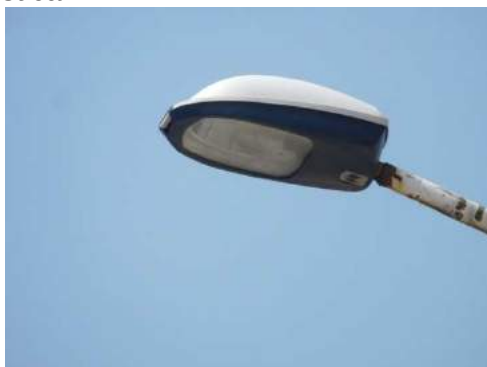
Armatura stradale con lampada SAP
